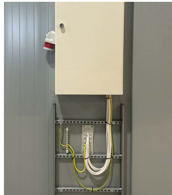
Kuva 2. Valmis kytkentäpaikka varavoimakoneelle
