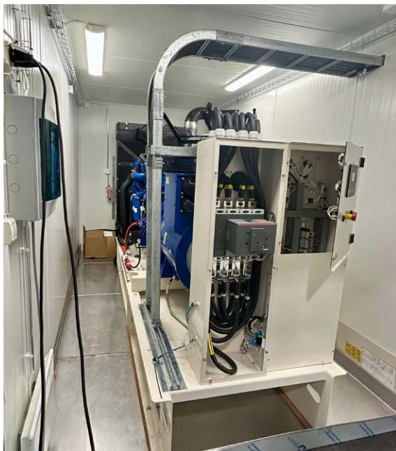
Kuva 1. Merikonttiin rakennettu varavoimakone
