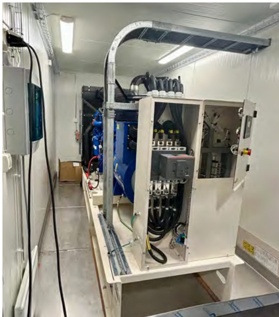
Bild 1. Reservkraftverk i en container
