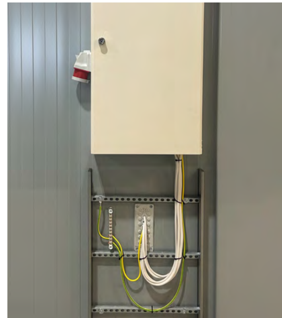
Bild 2. Färdig anslutningsplats för reservkraftverk
